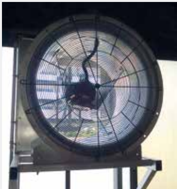
|3| Maschinelle Entrauchung Lagerhalle
