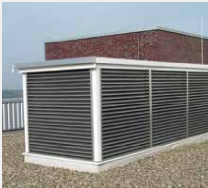
|2| Taurus im Lamellenlüfter Lyra
