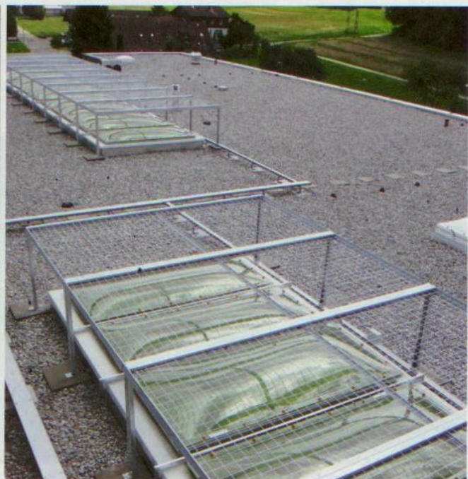
Gitterabdeckung als Absturzsicherung über dem Oberlicht.
